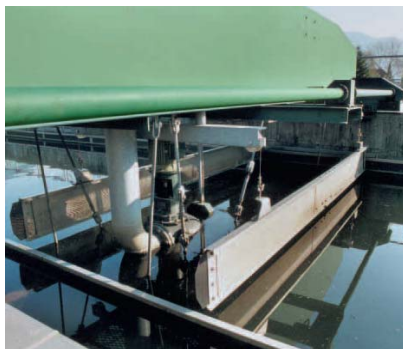
Rücklaufschlammpumpe, auf Räumbrücke installiert
