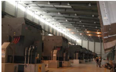
Blick in die Motorenhalle mit 13 installierten Motoren
