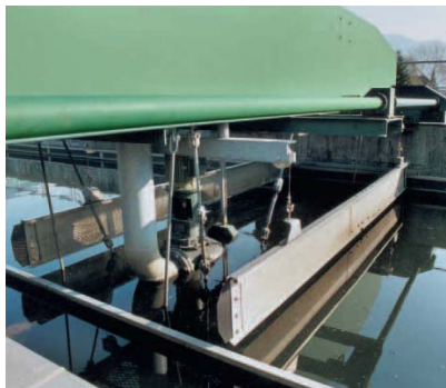
Rücklaufschlamm- pumpe, auf Räumbrücke installiert
