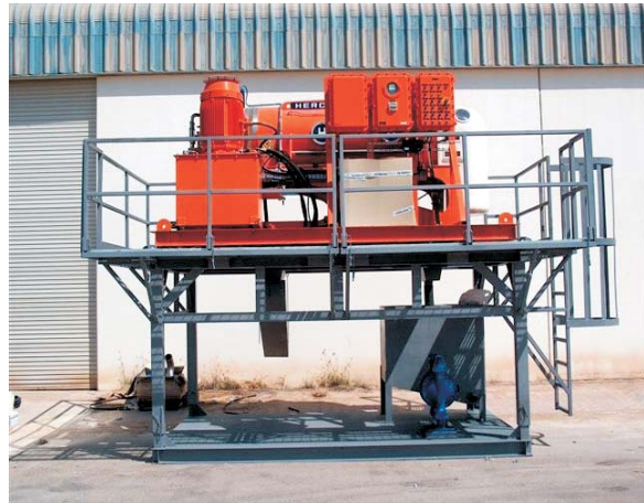
Nachgeschalteter Pieralisi-Dekanter für die Aufbereitung von Slop Oil in die Phasen Wasser & Öl
