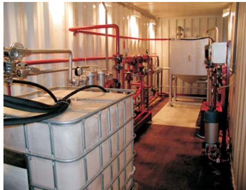
Demonstrationsanlage in einem 40'-Container auf dem Gelände eines Schlammöl-Entsorgers
