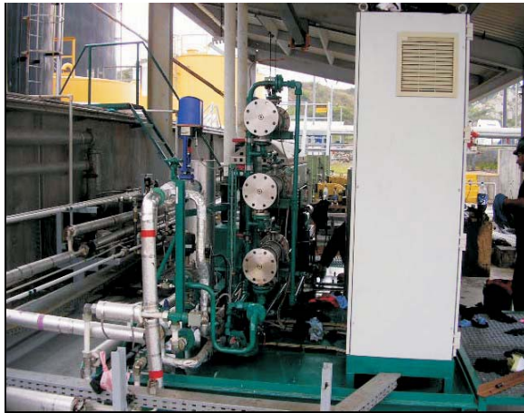
Spezielle Ultraschall-Technologie zur Aufspaltung der stabilen Wasser/Öl-Emulsion auf Power Plant in Honduras
